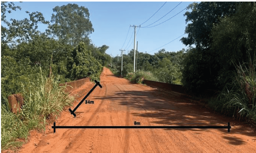
Figura 1 – Completa inexistência de sistema de sinalização Fonte – Comitê de Fiscalização de Pontes e Viadutos, 2026
