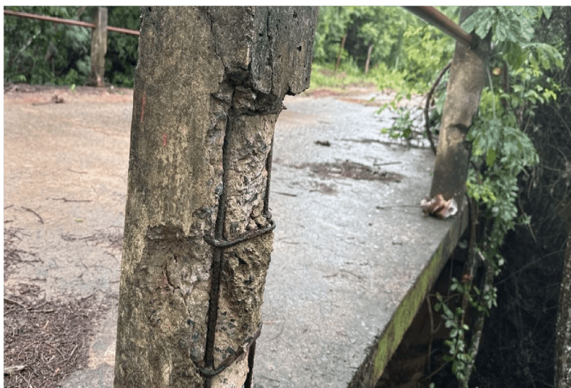
Figura 6 – Pilaretes do guarda-corpo com problemas de infiltração e deslocamento Fonte – Comitê de Fiscalização de Pontes e Viadutos, 2026
