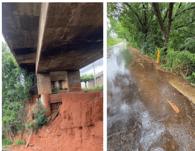
Figuras 16 e 17 – Estruturas com ocorrência de infiltrações e acúmulo de água no pavimento Fonte – Comitê de Fiscalização de Pontes e Viadutos, 2026
