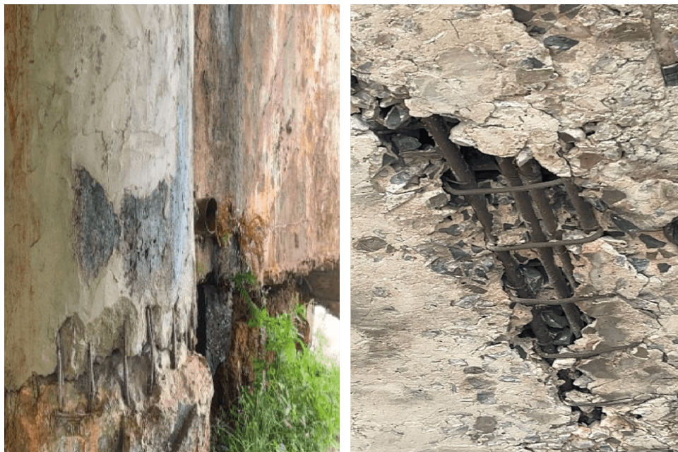
Figuras 10 e 11 – Estruturas com a presença de armaduras expostas Fonte – Comitê de Fiscalização de Pontes e Viadutos, 2026
