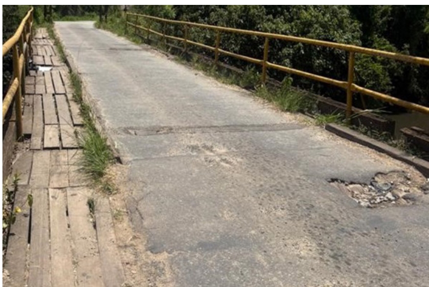
Figura 12 – Em algumas OAEs foi observado que o projeto da estrutura é completamente precário e inadequada para o trânsito de caminhões pesados, veículos leves e pedestres. Fonte – Comitê de Fiscalização de Pontes e Viadutos, 2026
