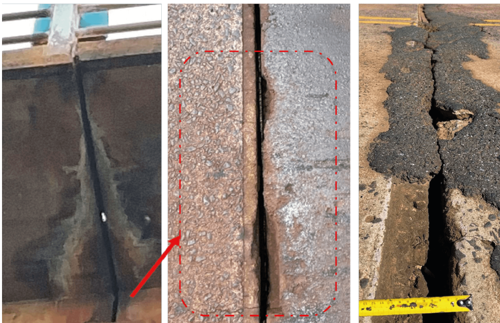
Figuras 7, 8 e 9 – Juntas de dilatação com problemas de aberturas excessivas Fonte – Comitê de Fiscalização de Pontes e Viadutos, 2026
