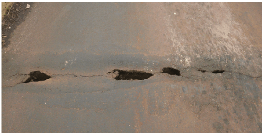
Figura 13 – Estrutura com o pavimento precário ao trânsito de veículos Fonte – Comitê de Fiscalização de Pontes e Viadutos, 2026
