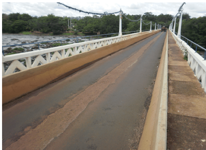
Figura 18 – Estruturas com problemas de segurança operacional Fonte – Comitê de Fiscalização de Pontes e Viadutos, 2026
