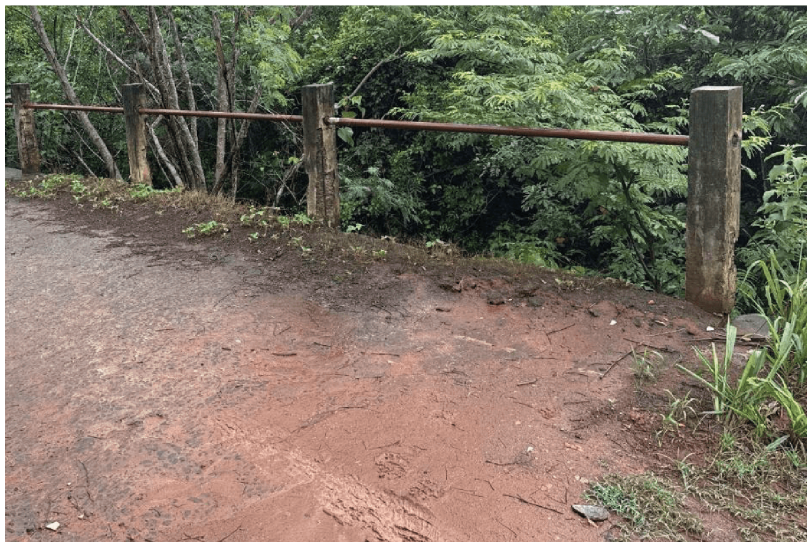
Figura 5 – Pilaretes do guarda-corpo com problemas de infiltração e deslocamento Fonte – Comitê de Fiscalização de Pontes e Viadutos, 2026
