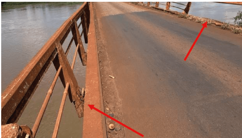
Figura 4 – Guarda-corpo totalmente danificado e com ausência de substituição de peças Fonte – Comitê de Fiscalização de Pontes e Viadutos, 2026
