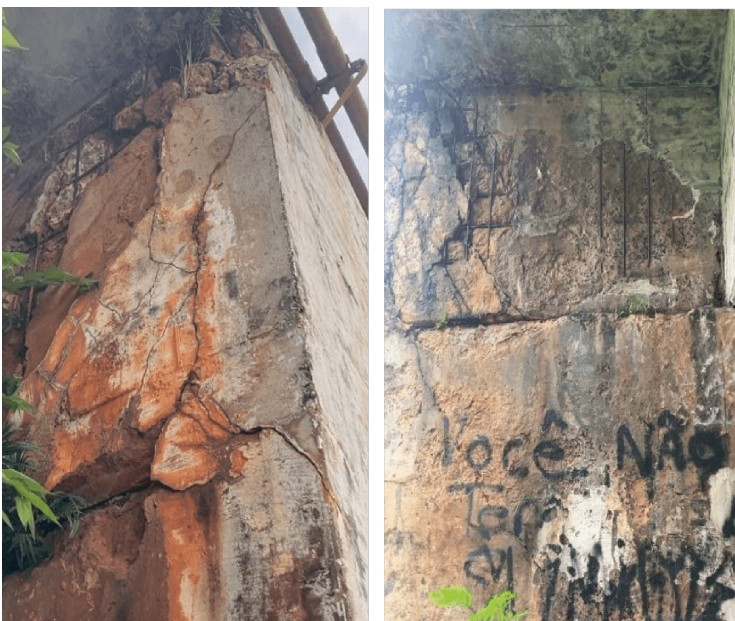
Figuras 2 e 3 – Problemas na região dos encontros entre a estrutura e o talude Fonte – Comitê de Fiscalização de Pontes e Viadutos, 2026
