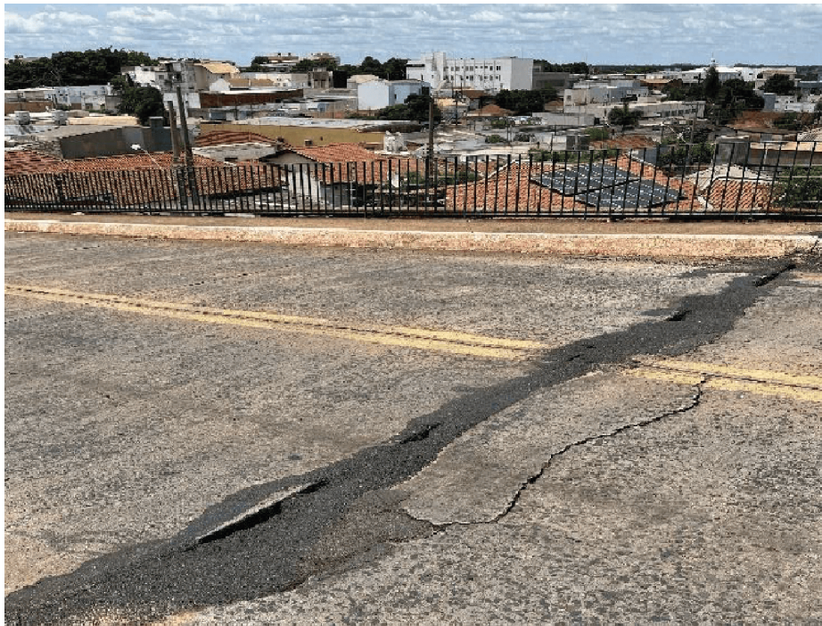
Figura 14 – Estruturas com a presença de ondulações e deformações superficiais Fonte – Comitê de Fiscalização de Pontes e Viadutos, 2026
