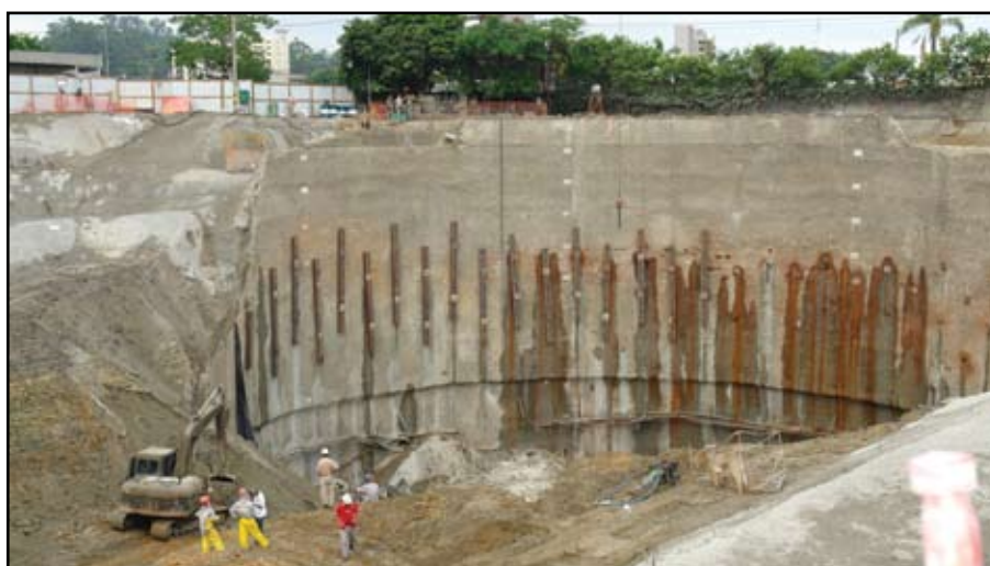
Acidente no Metrô - Linha 4 (12 de janeiro de 2007)
