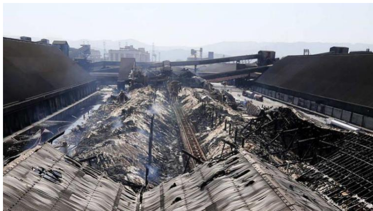
Figura 4 – Incêndio em terminal açucareiro (Santos – SP).
